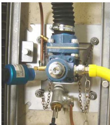
Bruciatore a doppio combustibile , gas e olio leggero
