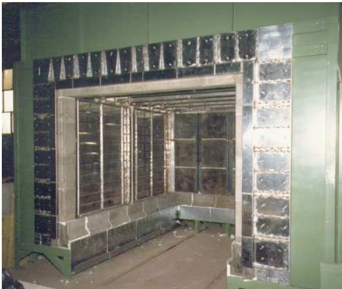
Forno a carro per fusioni in acciaio, tipo a circolazione d'aria forzata
